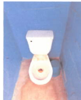
Foto 2: SERVICIOS SANITARIOS Y SUS ACCESORIOS
